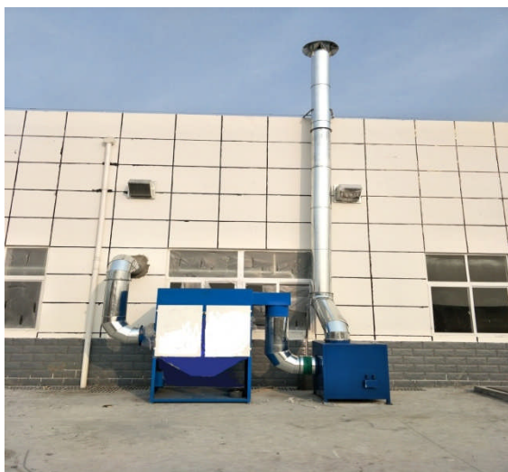
机修分厂钣金废气处理设施
