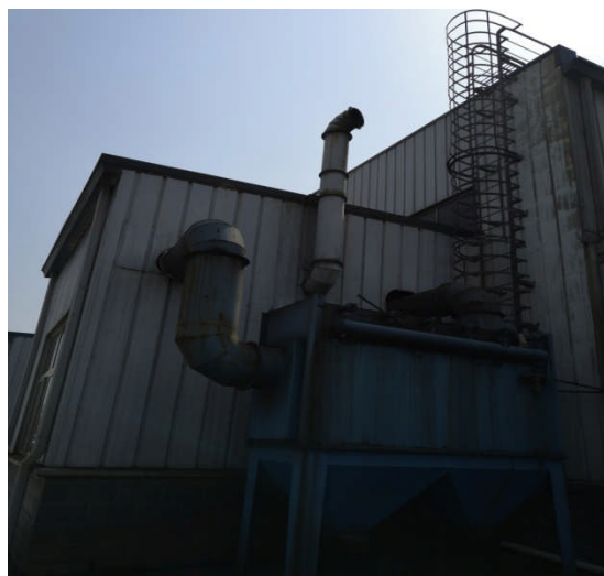
传动轴分厂抛丸工段废气处理设施
