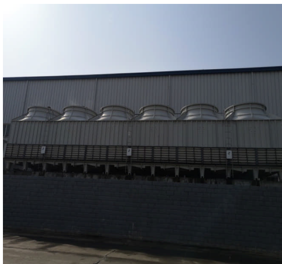
冷却水循环冷却系统
