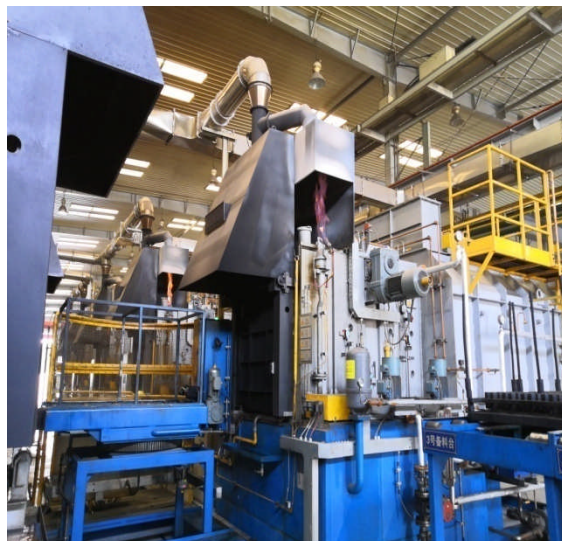
热处理分厂废气处理设施（二）
