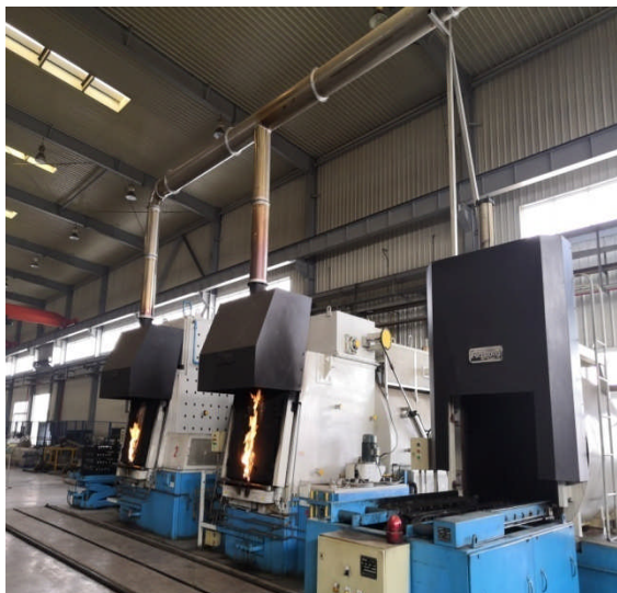
热处理分厂废气处理设施（一）
