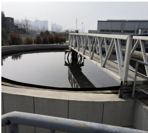
污水站处理设施
